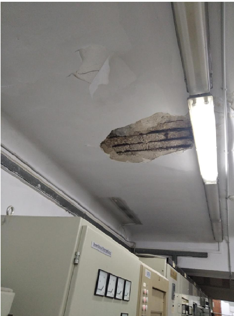
ΕΣΩΤΕΡΙΚΑ ΤΟΥ ΥΠΟΣΤΑΘΜΟΥ
