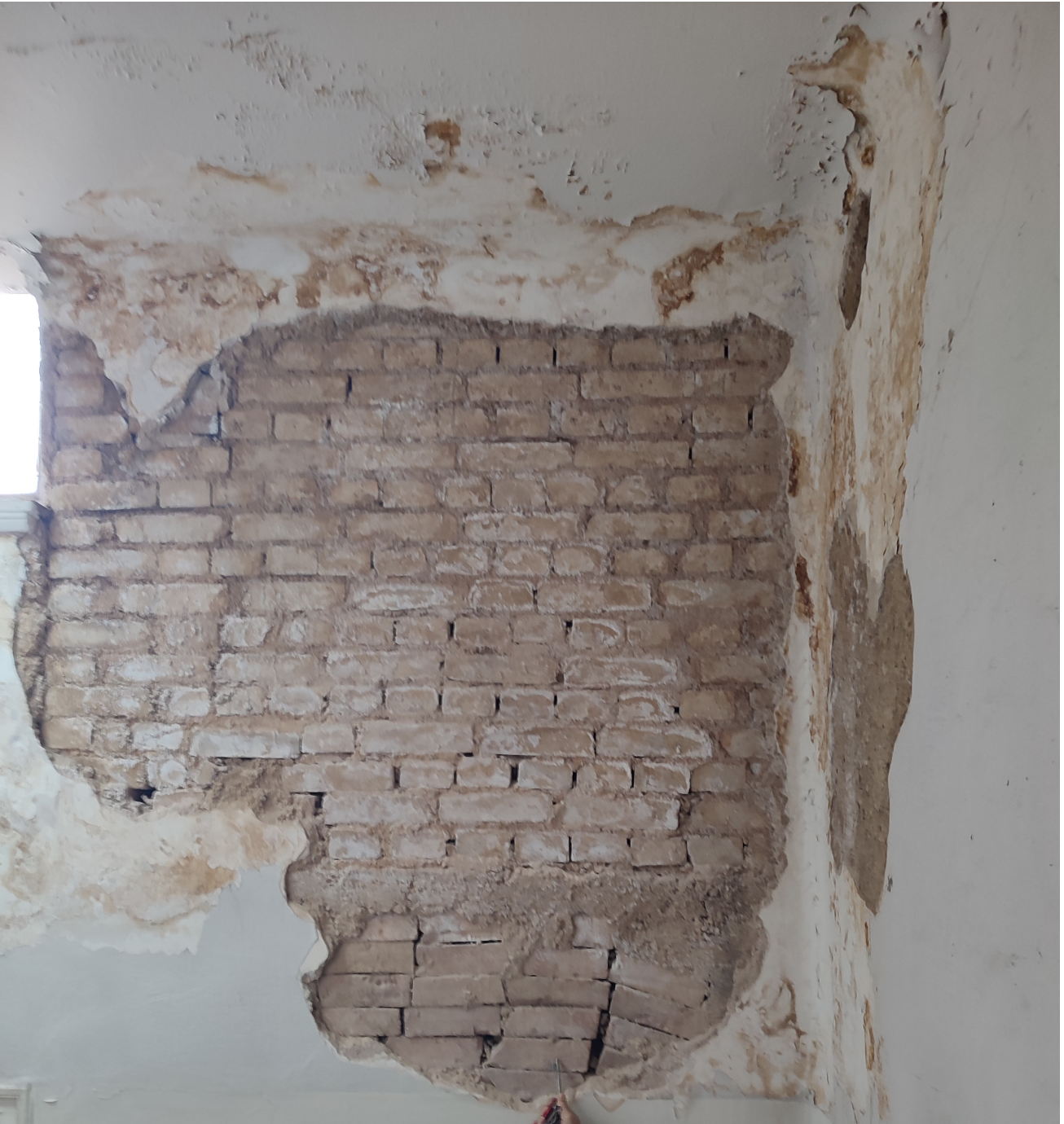
Εικ. 1 Φθορές επιχρισμάτων τοιχοποιίας κλιμακοστασίου μεταξύ 5 ου και 6 ου ορόφου
