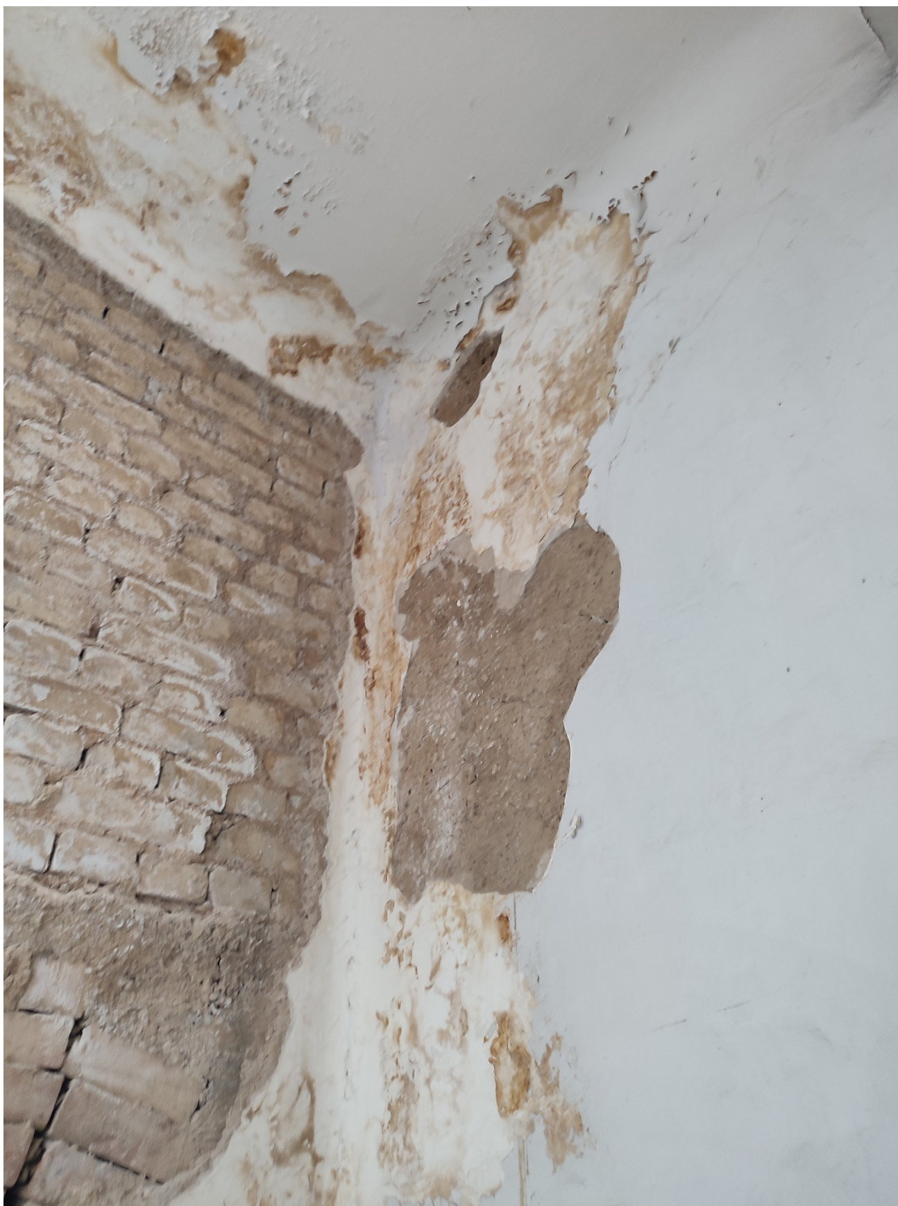
Εικ. 2 Φθορές επιχρισμάτων – υγρασίες τοιχοποιίας κλιμακοστασίου μεταξύ 5 ου και 6 ου ορόφου
