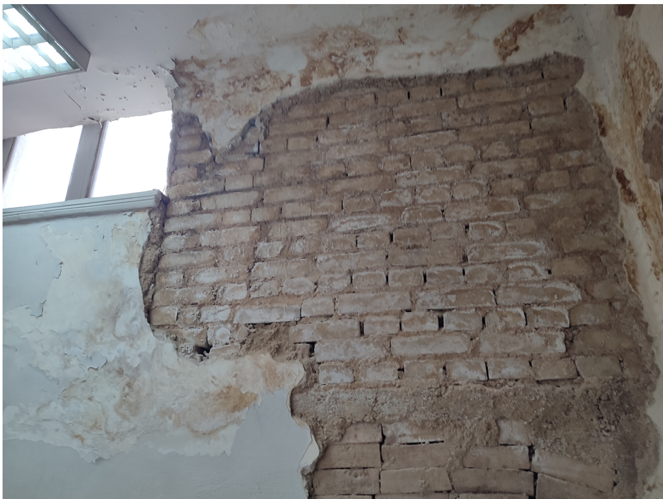
Εικ. 3 Φθορές επιχρισμάτων – υγρασίες τοιχοποιίας κλιμακοστασίου μεταξύ 5 ου και 6 ου ορόφου
