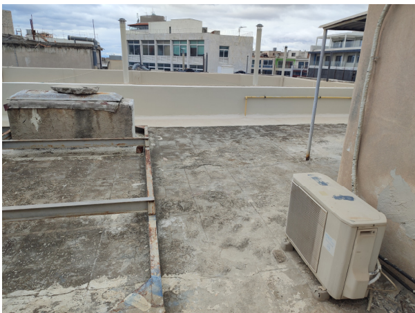
Εικ. 1 Δάπεδα δώματος, μεταλλικές κατασκευές- βάσεις που πρέπει να αφαιρεθούν
